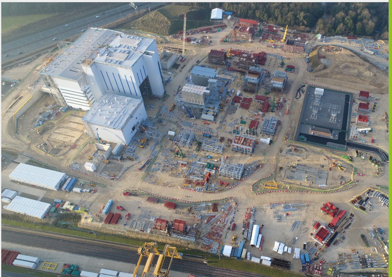
Im Bau befindliche Anlage zur Energierückgewinnung aus Abfall in Ferrybridge, Vereinigtes Königreich
