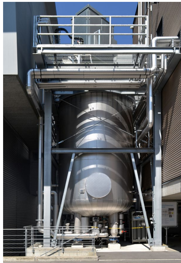
Methanisierungsreaktor des BiON ® -Verfahrens
