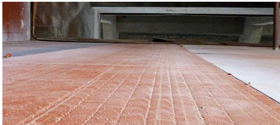
EfW-Anlage Zorbau L2 – Für die Innenflächen auf der Bunkerseite wurden verschiedene Materialien (Schweissplattiert 12+4 und S235JR 16mm) verwendet.
