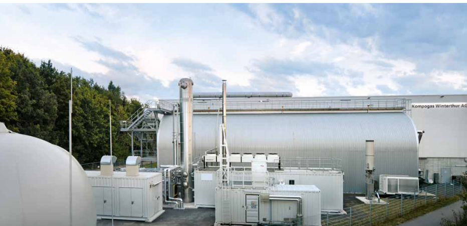
Kompogas®-Anlage mit HZI BioMethan Biogasaufbereitung in Winterthur, Schweiz
