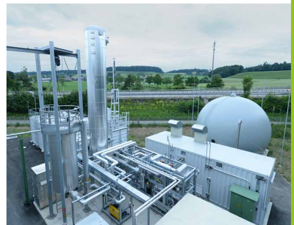
HZI BioMethan-Anlage mit Aminwäsche in Winterthur, Schweiz
